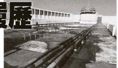
会展中心屋顶因ABS水管有11处破漏，造成一片泥泞。
